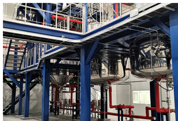
Рисунок 3. Участок нейтрализации рыбного жира Figure 3. Fish oil neutralization site
