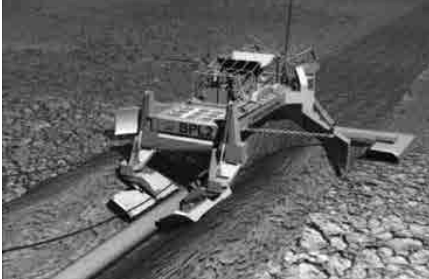
Рис. 2.10. Укладка трубопровода в траншею на морском дне с помощью плужного агрегата с обратной засыпкой
